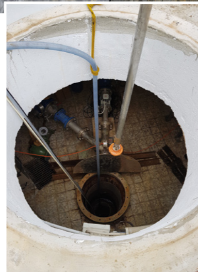
Oben links: Rohrkeller Übergabestation Walzbachtal
